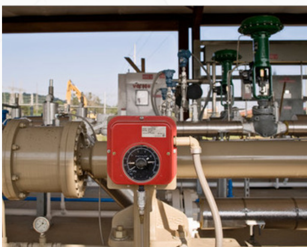
Estação de injeção de CO 2 da American Electric Power's Mountaineer, New Haven, W.Va. Foto de Kevin Riddell/The New York Times
